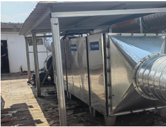
环保设施（过滤棉+二级活性炭吸附装置） 图片
