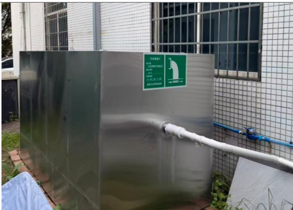
图 3.1-3 迁建项目切割废水预处理设施（过滤+沉淀）图片
