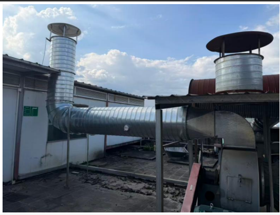
废气排放口标志牌远照（气-01）
