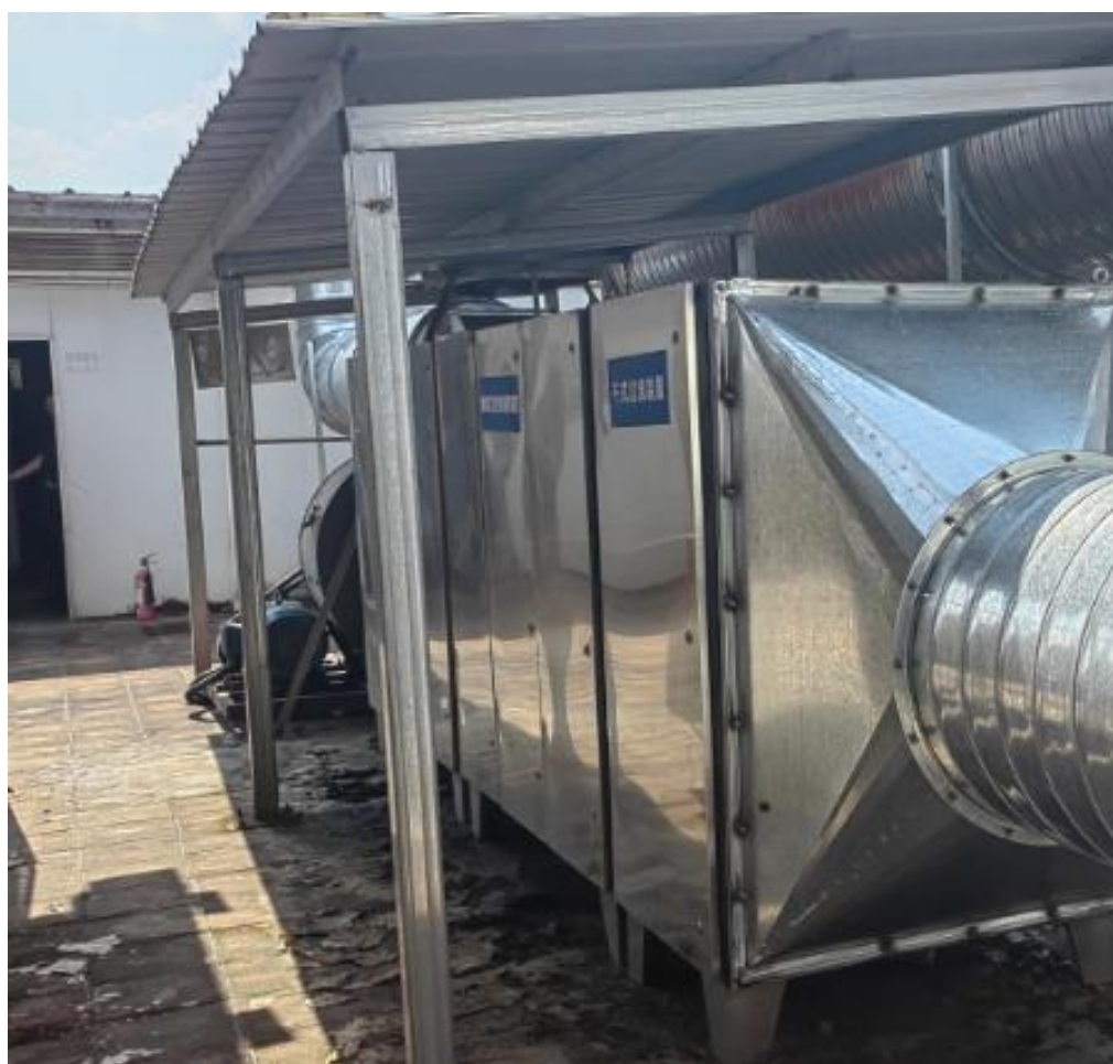
图 3.1-6 迁建项目废气处理设施（过滤棉+二级活性炭）图片
